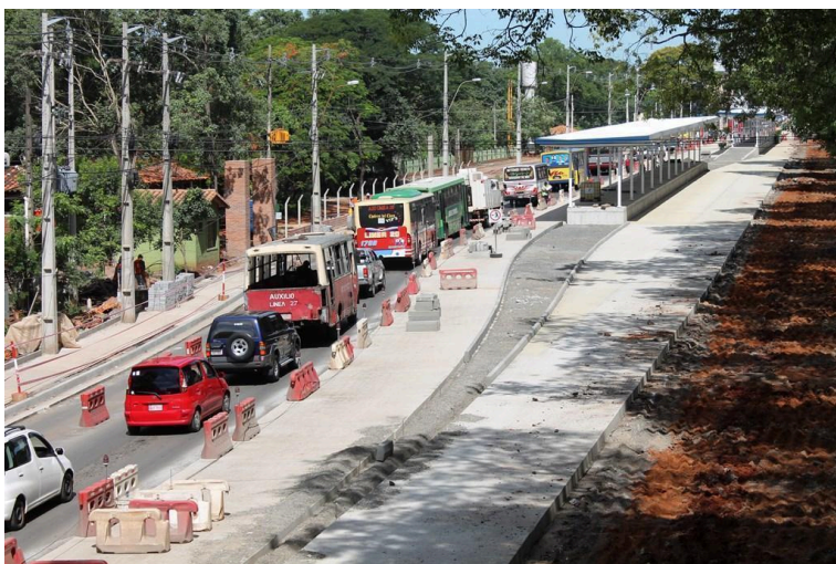
Figura 46 - Asunción: BRT parcialmente construido y destruido con el proyecto abortado.
