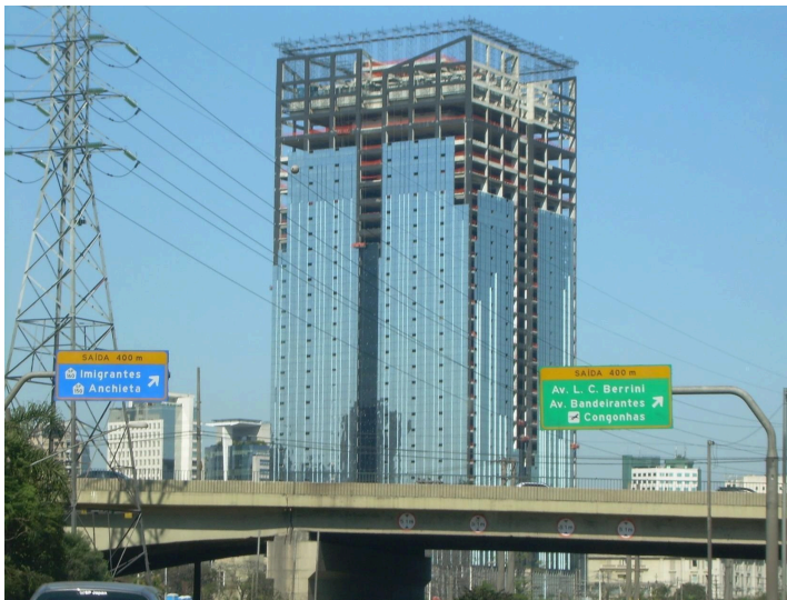
Figura 11 – CODC aplicado en un edificio en São Paulo
